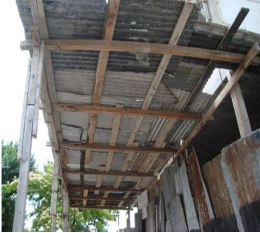
Fig. 5: Bandeja fija sobre la vía pública. PH1
