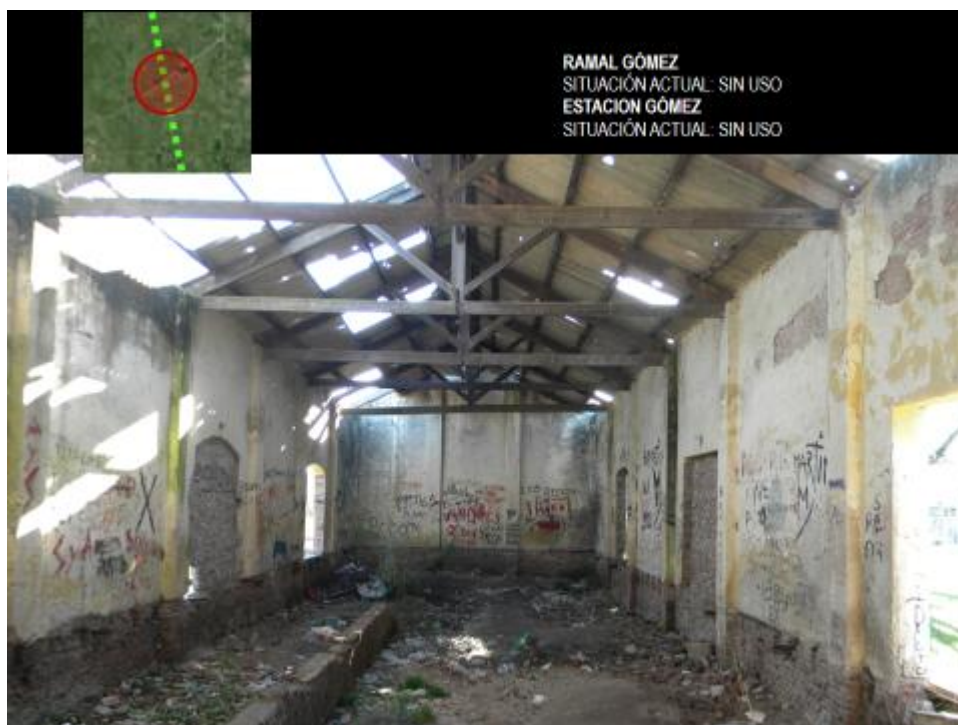
Figura 16: Estación Gómez, estado de abandono
